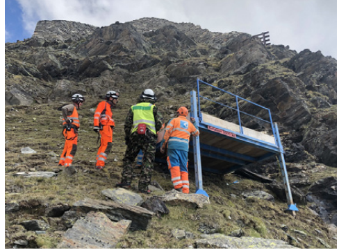
Installation für die Wasser-Container
